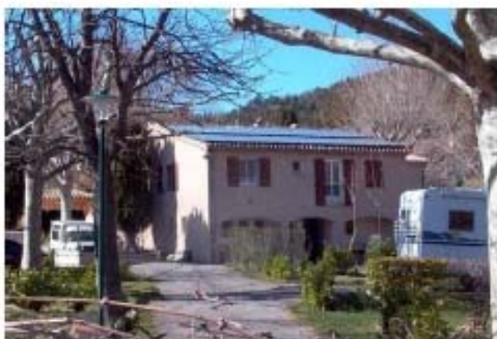
Toiture avec une couverture quasi-totale de panneaux solaires en surimposition (bâtiment d'un camping)
