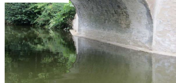
Rejointoiement généralisé de la voute et d'une partie des tympans. Pose de nichoirs à chiroptères.
