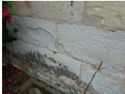
Détachement en plaques
