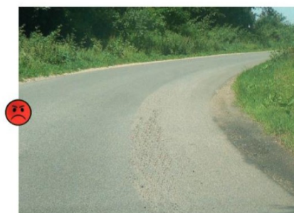
Les enduits superficiels sont essentiellement réalisés sur les routes secondaires en rase campagne. Ils s'accompagnent de gravillonnages présentant de sérieux risques de glissance pour les 2RM.
