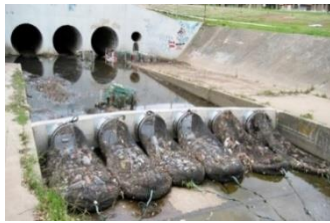
Filets sur exutoires ( http://stormwatersystems.com )
