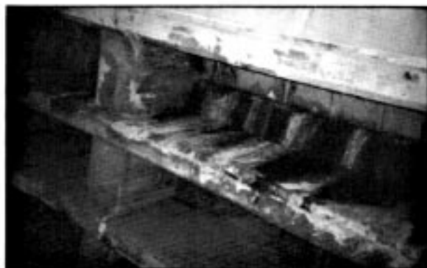
Photo 2 : Le même hourdis vu de dessous.
