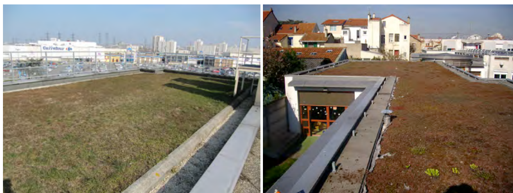
Figure 17 TTV de la Direction de l'Eau et de l'Assainissement du Conseil Général 93 à gauche (CD93), et TTV de la crèche Renaudin à Clamart (CD92)
