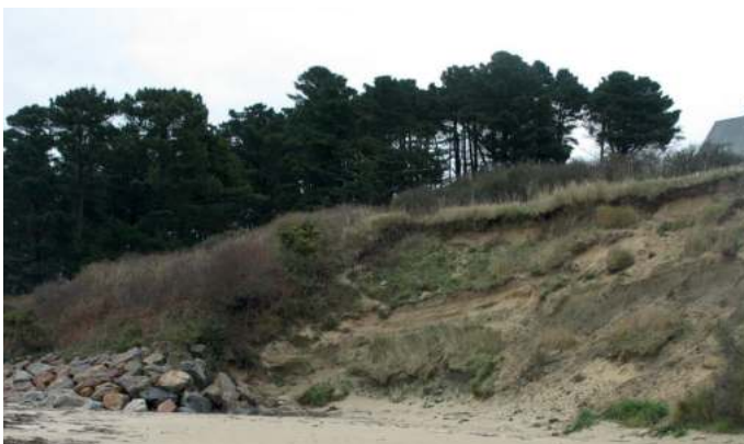
Figure 8-1 (c) : dune déstabilisée en amont-dérive par effet de bord d'un enrochement (Plestin-Les-Grèves, plage du Hogolo, décembre 2008). Vue prise vers le nord.
