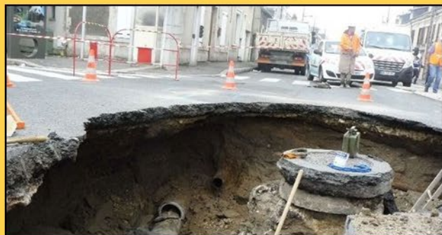
Effondrement d'une rue (La République du Centre)
