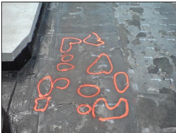
Photo 9 : localisation des défauts (Cerema)
