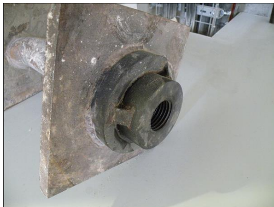
Figure n°23 : Ecrou et contre-écrou récupérés sur un puits de la dalle
