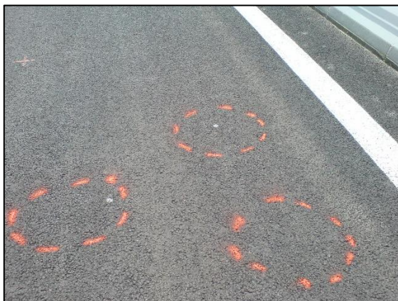
Photo 3 : localisation des défauts sur enrobé (Cerema)
