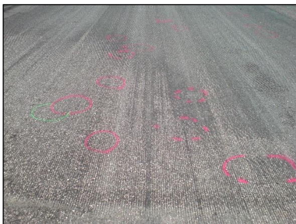
Photo 5 : localisation des défauts après rabotage (Cerema)
