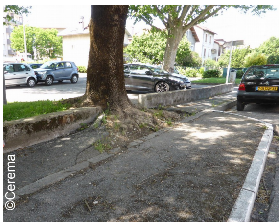
Illustration 20: Revêtement déformé par la présence de racines d'arbres
