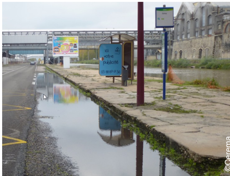
Illustration 10: Revêtement très dégradé
