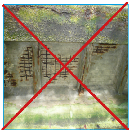
Décollement généralisé de l'enrobage
