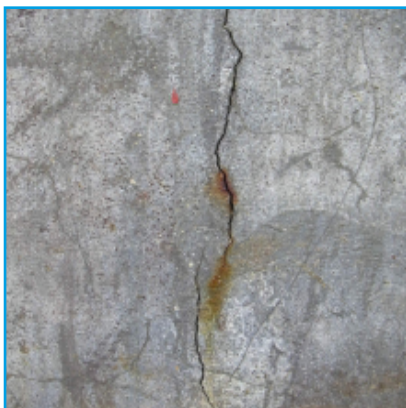
Fissure due à la corrosion
