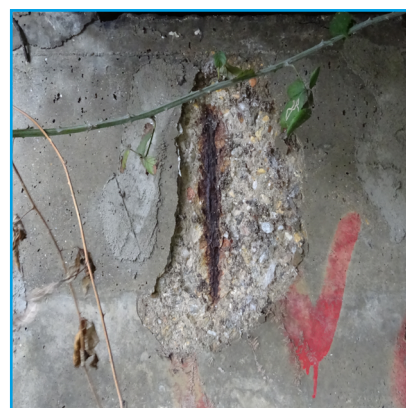
Éclat dû à la corrosion
