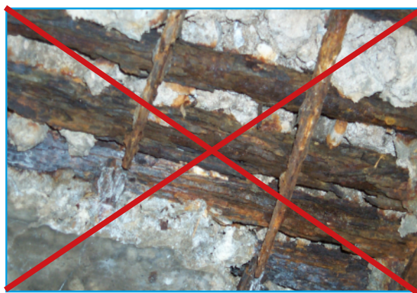
Perte significative de section d'armature
