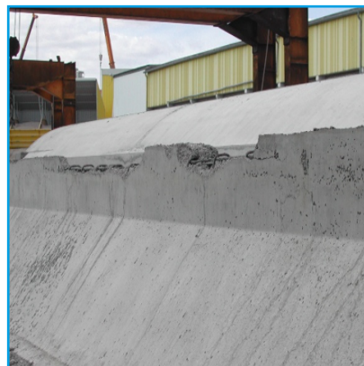
Défauts de bétonnage
