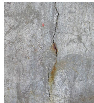
Fissures dues à la corrosion
