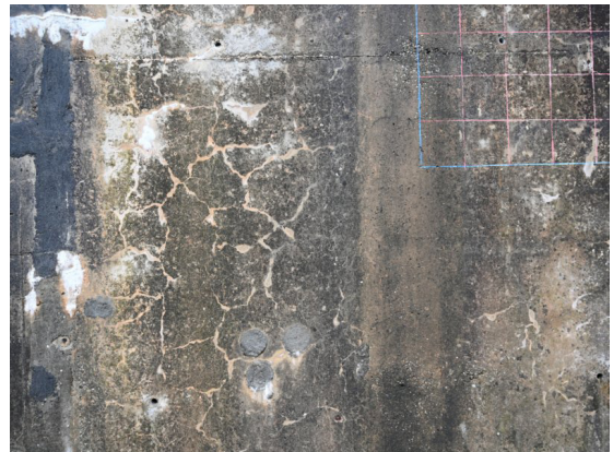
Fissuration due à une réaction de gonflement interne stabilisée
