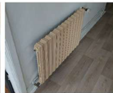
Radiateurs en fonte sur pièces en rez-de-chaussée
