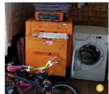
Chaudière GAZ et lave-linge dans la chaufferie, installation au sol
