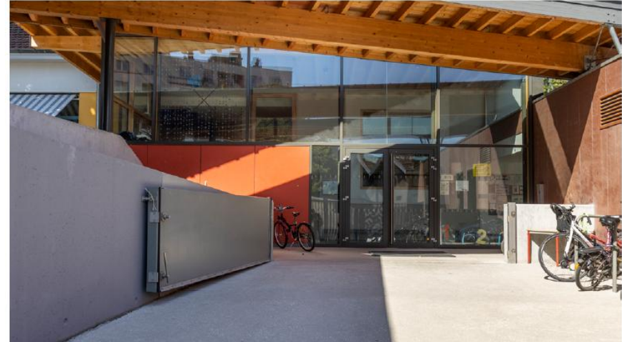
Porte étanche à l'entrée du groupe scolaire Diderot, la rampe permet d'en diminuer la hauteur
