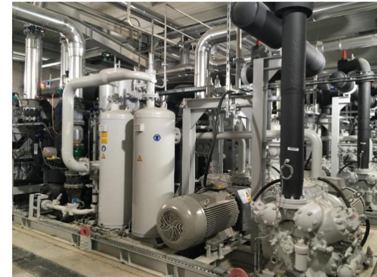
PAC installées (décembre 2019)
