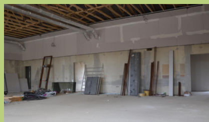
Photo : Commune de Rochefort-du-Gard
