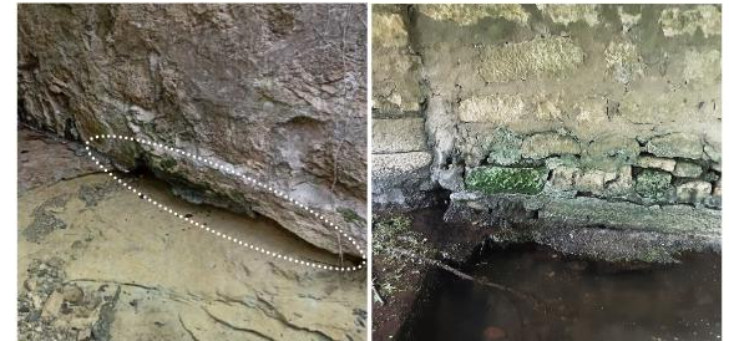
Figure 1 : illustrations d'une cavité sous le pied d'un appui
