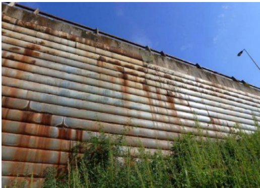
Figure 5 : Corrosion perforante des écailles
