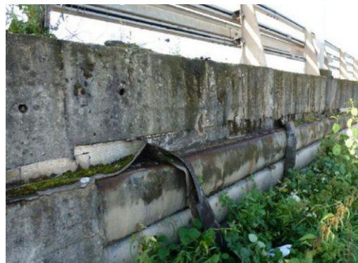
Figure 6 : Désorganisation de l'étanchéité
