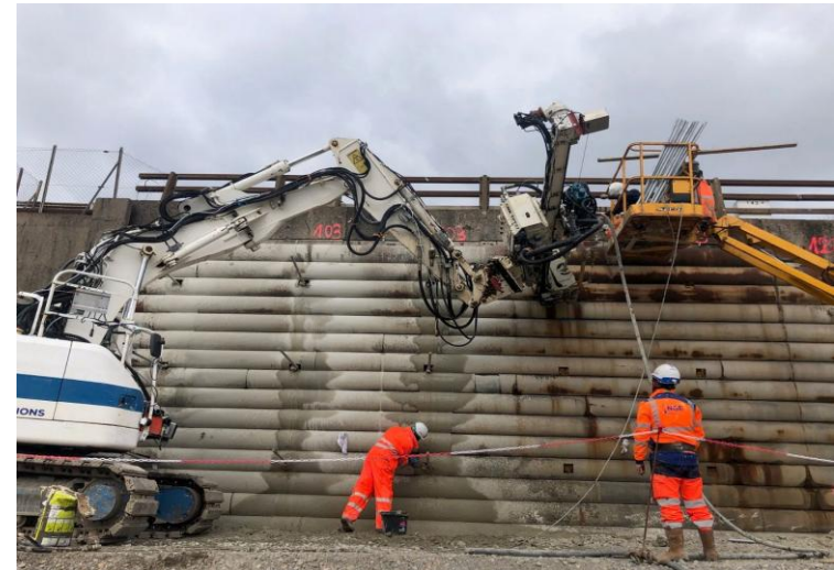
Figure 36 : Forage d'un clou côté Nord
