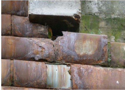
Figure 3 : Risque de chute d'écaille
