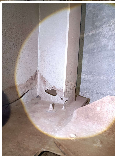
Corrosion avancée d'un about de poutre – perforation de l'âme de la poutre
