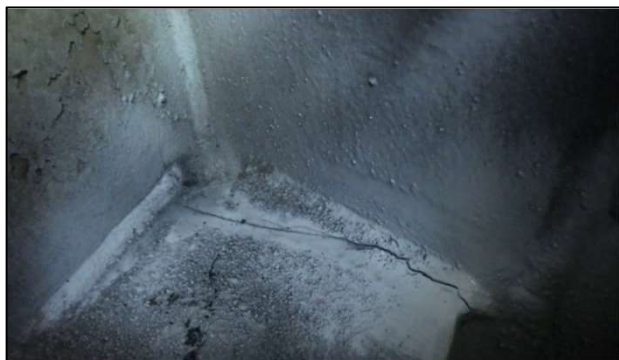
Fissure identifiée sur un raidisseur après grenaillage
