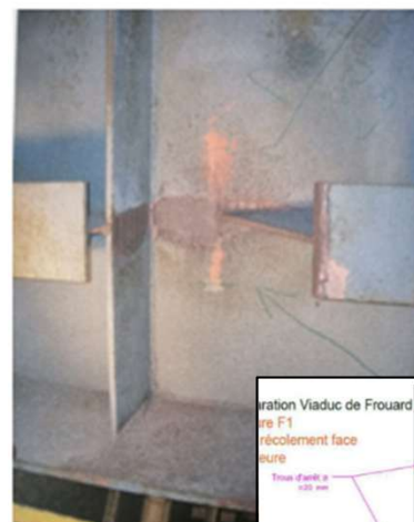
Fissure 1 : Poutre A.
