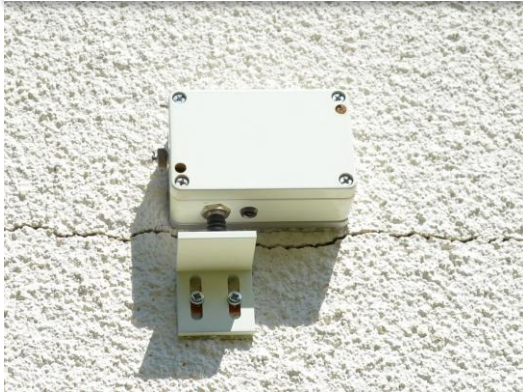
Suivi des fissures
