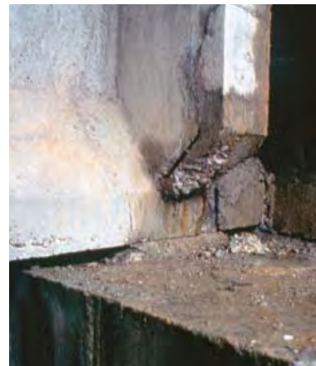
Photo n° 5 : défaut d'étanchéité du joint de chaussée ou de trottoir, provoquant des coulures d'eau et le décollement du cachetage de la précontrainte transversale d'un VIPP Source : RST
