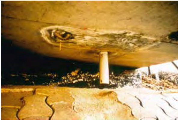
Photo n° 11 : défaut d'étanchéité au droit d'une réservation de gargouille mal réalisée – Source : RST
