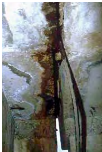
Photo n° 4 : le joint n'est plus étanche par dégagement du caoutchouc + défaut d'étanchéité à l'about du tablier Source : RST
