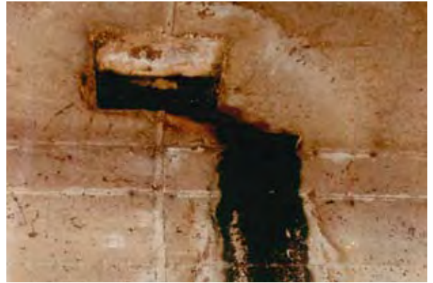
Photo n° 12 : défaut d'étanchéité au voisinage de la fixation de la platine inférieure d'une glissière de sécurité. Coulures d'eau en sous-face de la membrure supérieure d'une poutre de VIPP. La couleur rougeâtre témoigne d'un processus de corrosion d'acier – Source : RST
