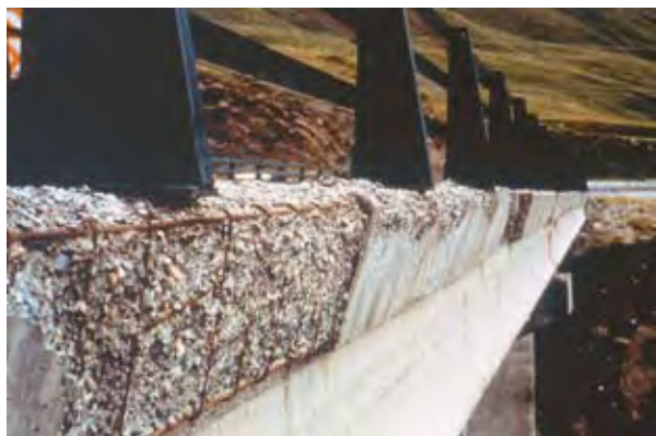
Photo n° 15 : écaillage et éclatement du béton d'une corniche de tablier, sous l'action du gel-dégel, éventuellement complétée par l'attaque des sels de déverglaçage – Source : RST
