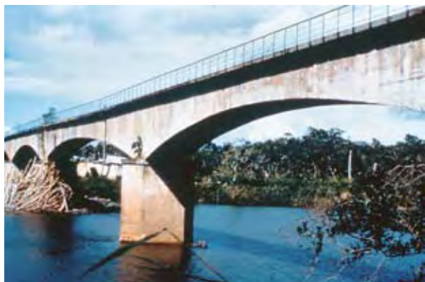
Photo n° 7 : amoncellement de corps flottants autour d'une pile Source : RST
