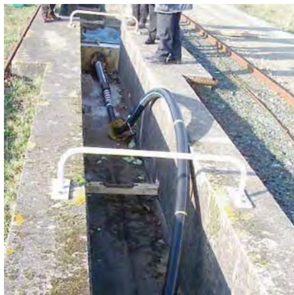
Photo 10 : flambement résiduel du câble avec amortisseur – Source : RST
