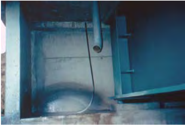
Photo n° 1 : extrémité du dispositif d'évacuation des eaux absente à proximité d'une poutre métallique – Source : RST
