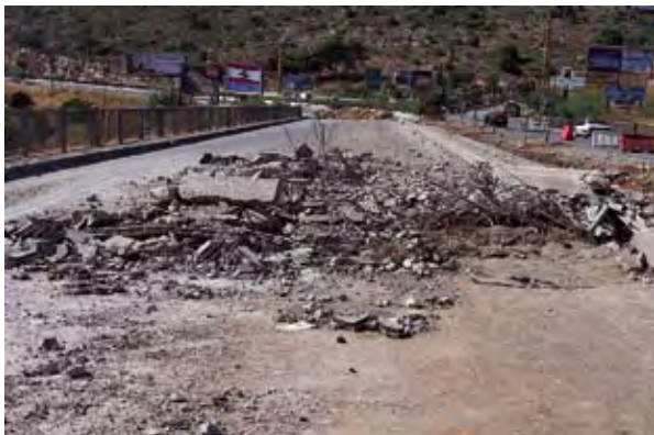
Photo 2 : désordres à la clé - vue depuis la chaussée aval Source : Antoine Salamé (Gicome)
