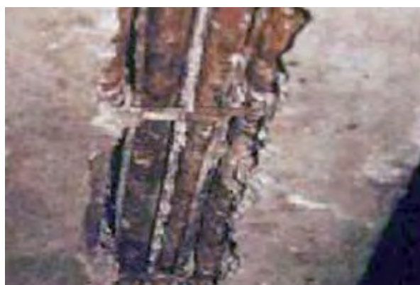
Photo n° 18 : défaut d'enrobage des armatures d'un talon de poutre de VIPP comprenant de nombreux conduits de précontrainte Source : RST
