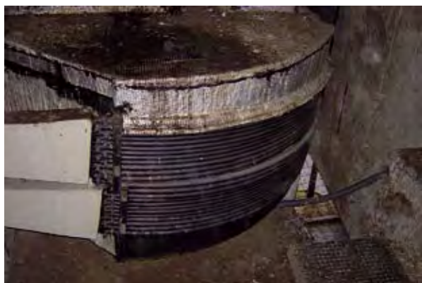
Photo 3 : détail du cantilever et du câblage - Source : Rst
