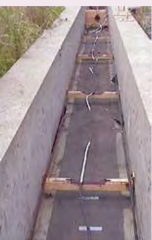
après la rupture
