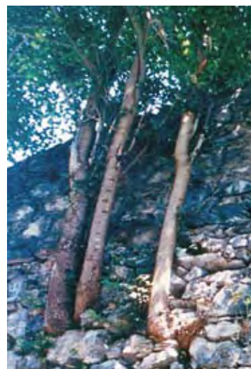
Photo n° 10 : végétation enracinée dans des lacunes, des cavités de la maçonnerie d'un mur de soutènement – Source : RST
