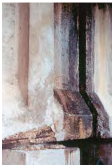
Photo n° 6 : défaut d'étanchéité du joint de chaussée ou de trottoir, provoquant des coulures d'eau en about de poutre de VIPP où se situent des ancrages de précontrainte – Source : RST
