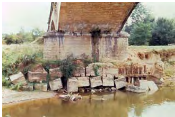
Photo n° 8 : érosion des berges et désorganisation de la protection de la pile avec mise à nu d'un encagement – Source : RST
