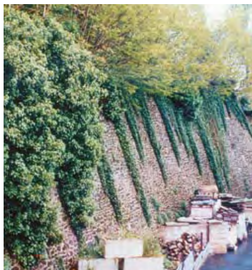
Photo n° 9 : végétation rampante sur le parement d'un mur de soutènement – Source : RST
