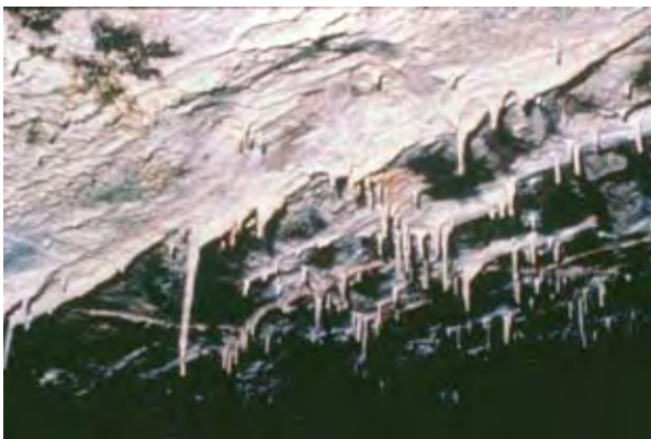
Photo n° 13 : stalactites actives provenant de la dissolution du mortier des joints entre pierres d'un pont en maçonnerie, par défaut ou absence d'étanchéité favorisant le cheminement de l'eau à travers l'ouvrage – Source : RST
