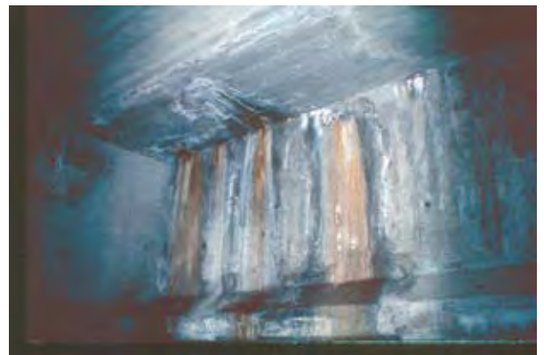
Photo n° 14 : efflorescences et coulures d'eau de couleur rouille, en extrémité d'une poutre de VIPP, le long de câbles relevés de précontrainte, par défaut d'étanchéité – Source : RST
