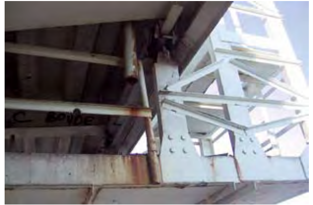
Photo n° 2 : chute d'eau sur une passerelle de visite devenue dangereuse et inutilisable – Source : RST
