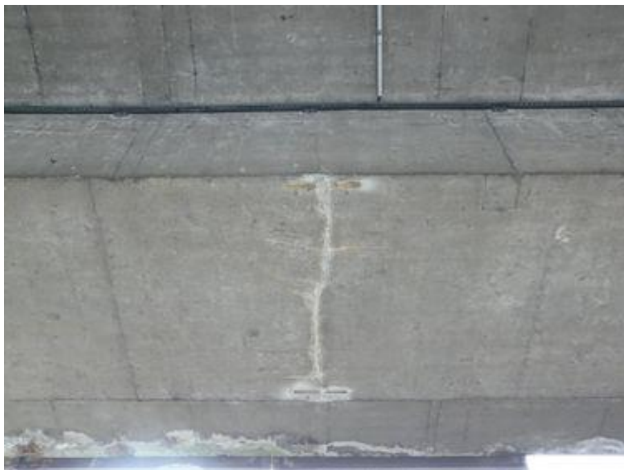
Figure 4. Fissure transversale du Caisson Ouest – Tablier Ouest
