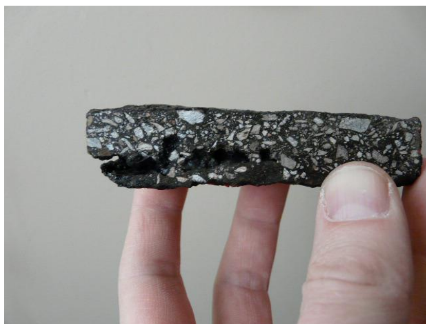
Figure 18. Vue sur le complexe d'étanchéité d'une carotte avec présence de vides dans la couche d'asphalte
