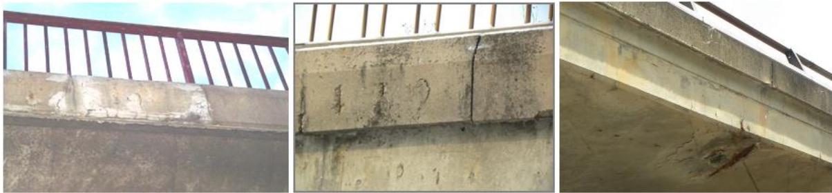
Figure 1. Vues de corniches endommagées
