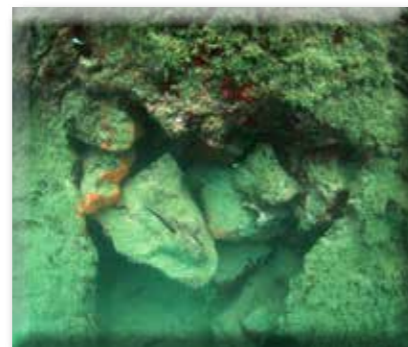
Désorganisation subaquatique d'un quai en maçonnerie
