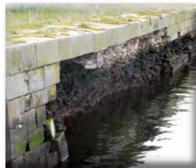
Ouvrage en ruine
